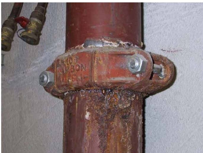
Bild 3 zeigt eine Sprinklerzuleitung die leckt, gemessener Strom 3,71 A
