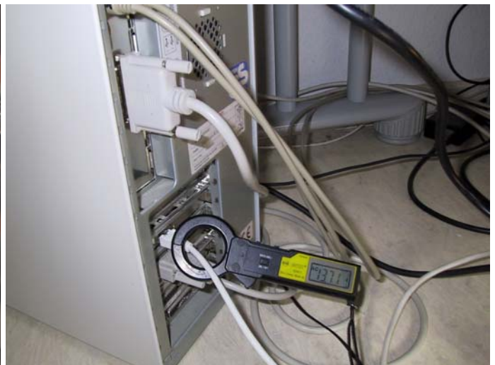
Bild 2 zeigt einen Strom von 13,71 A auf einer Datenleitung
