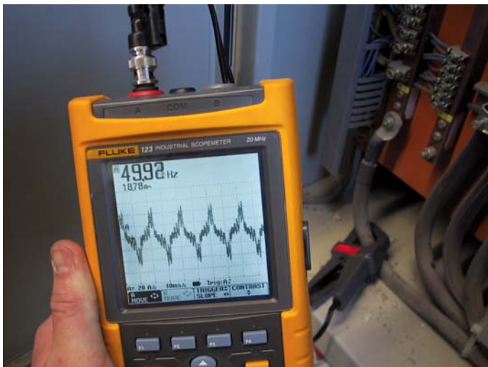
Bild 1 zeigt einen PE-Leiterstrom von 18,7 A
