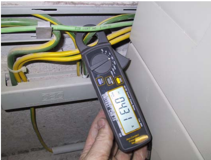
Bild 5 zeigt einen PE-Leiterstrom von 4,31 A
