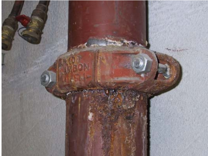
Bild 9 zeigt eine Sprinklerzuleitung die leckt, gemessener Strom 3,71 A
