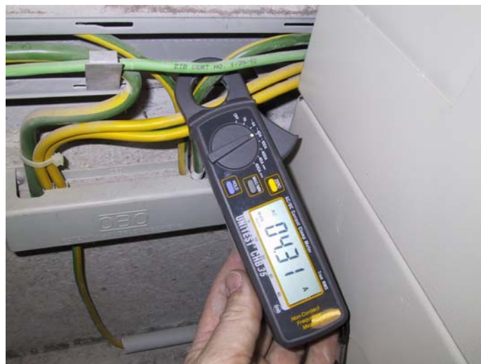
Bild 5 zeigt einen PE-Leiterstrom von 4,31 A
