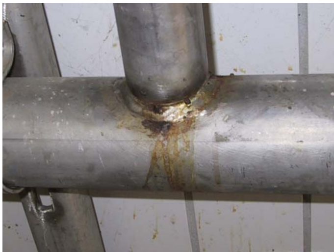
Bild 11 zeigt einen VA Wasserverteiler, der durch Wechselströme korrodiert ist
