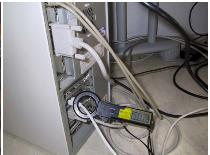
Bild 8 zeigt einen Strom von 13,71 A auf einer Datenleitung
