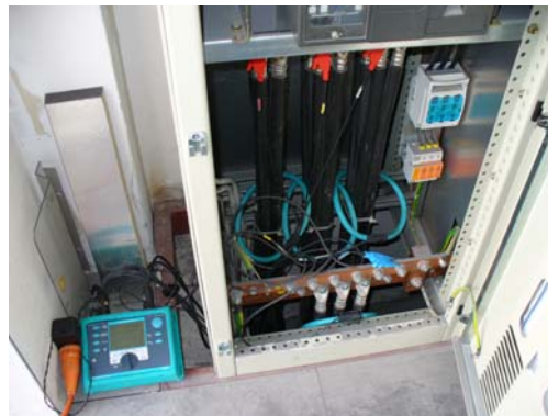
Netzanalyse in einer Schaltanlage
