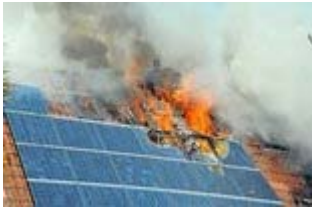
Häufig sind indirekte Einflüsse auf Photovoltaikanlagen, etwa Gewitter, Ursache für Großbrände. Foto: (Bodo Wolters)
